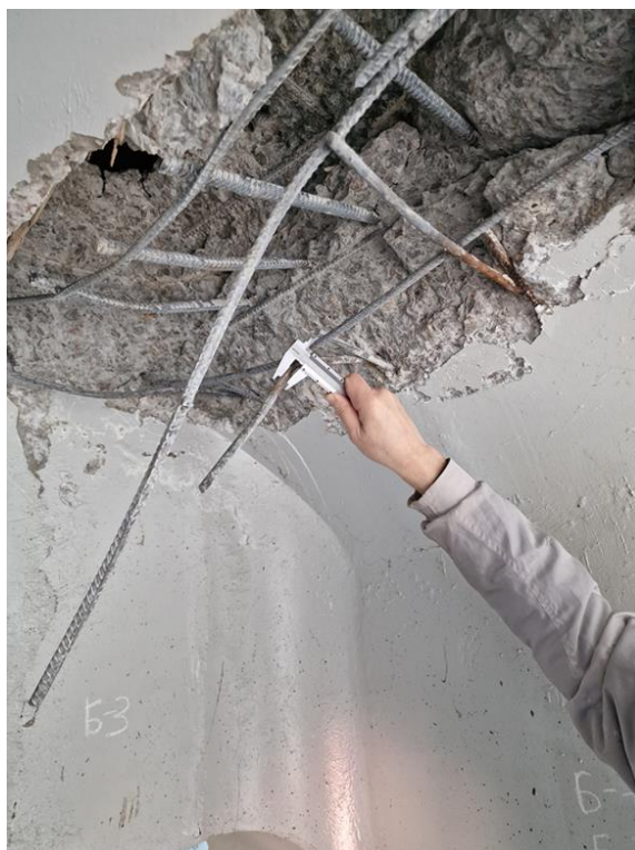
Рис. 5. Розшарування бетону, тріщини, руйнування, сколювання бетону, оголення і деформація арматури балки прогонової будови моста
