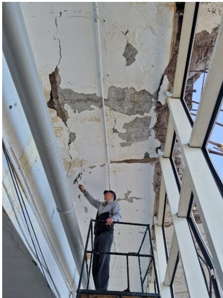
Рис.2. Характерне тріщиноутворення після ракетного удару, тріщини вздовж ригеля в залізобетонній плиті покриття будівлі
