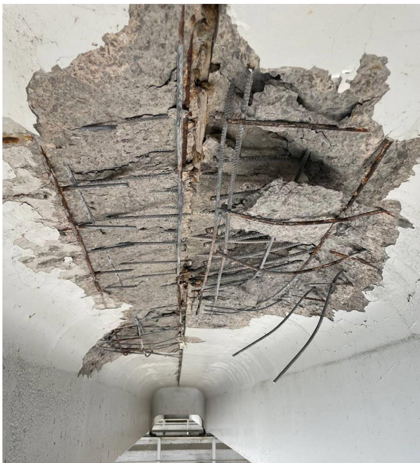
Рис. 4. Руйнування плитних частин балок прогону моста, вивал бетону, деформації, погнутість арматури, корозія, тріщини, порушення з'єднань арматури з протилежної від удару сторони прогонової будови
