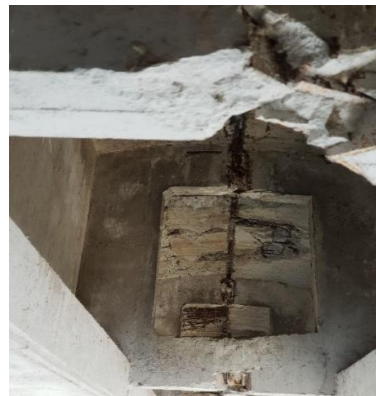
Рис. 3. Сколювання бетону, з оголенням арматури у з'єднаннях діафрагм прогонових будов
