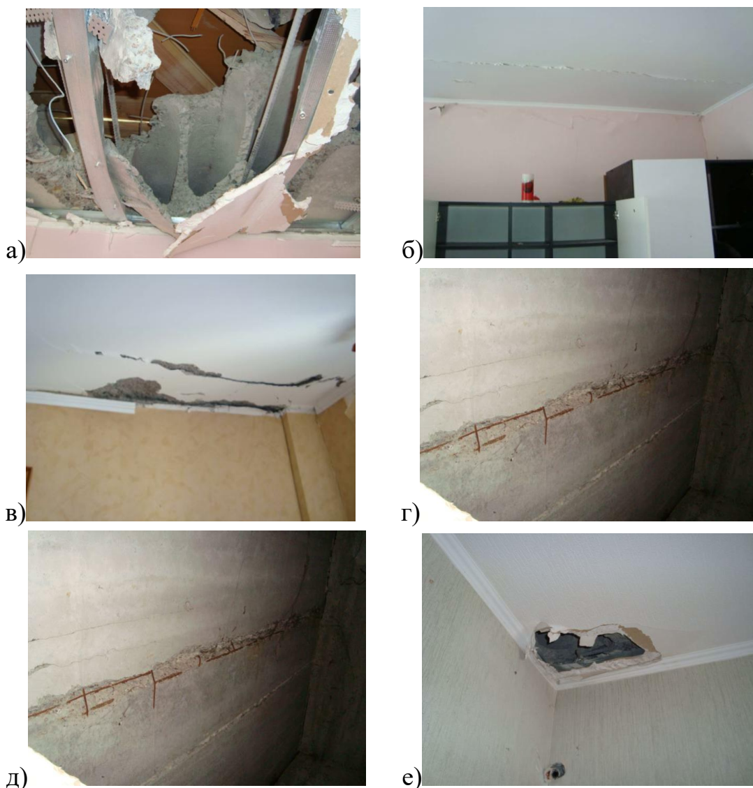
Фото 1 (а-е). Виявлені пошкодження збірних залізобетонних перекриттів
