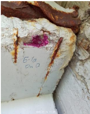
Рис. 2. Сколювання бетону, тріщини, корозія арматури балки Б-1в на опорі №0
