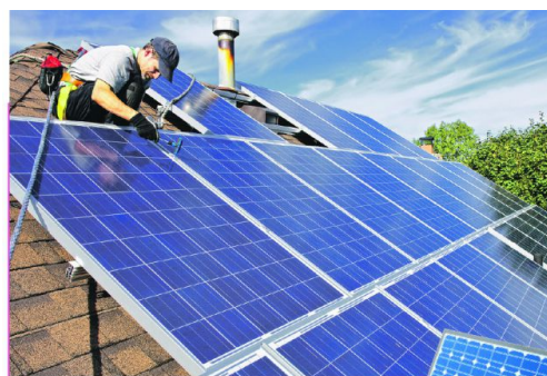
Установка сонячних батарей в Каховському районі Херсонської області. Який строк їх окупності у виробничих і домашніх умовах?
