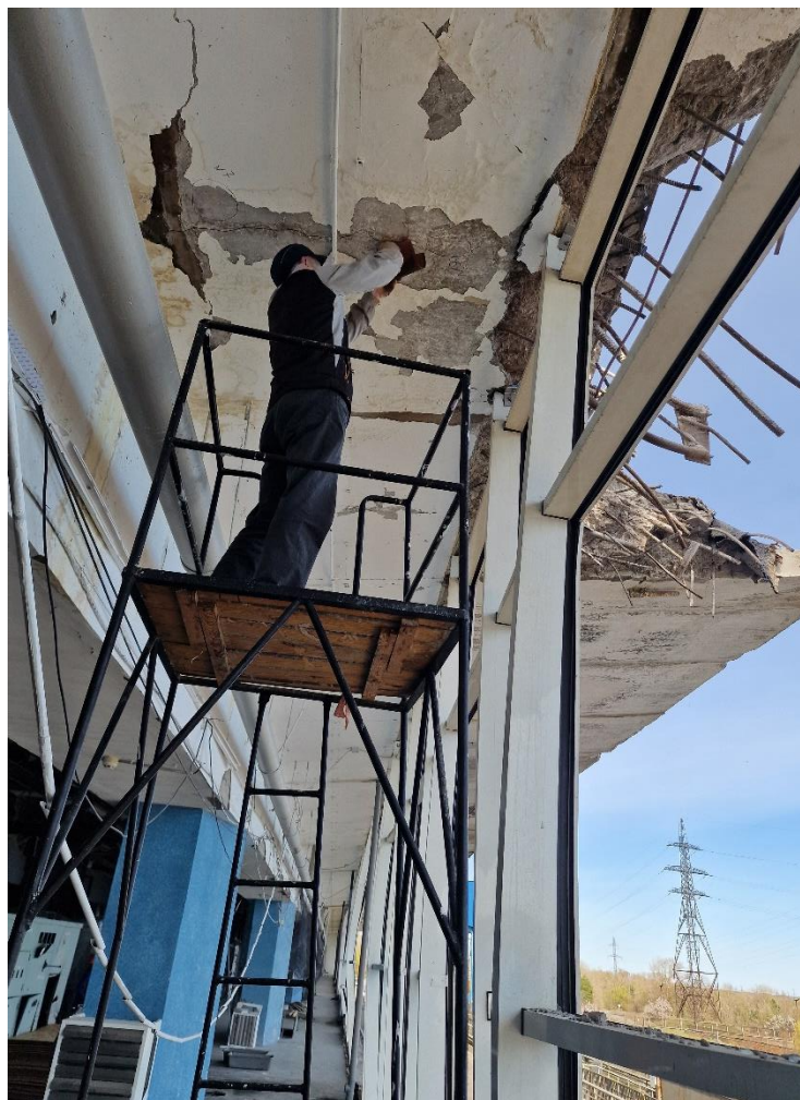
Рис.2. Характерне після ракетного удару тріщиноутворення в залізобетонній плиті
