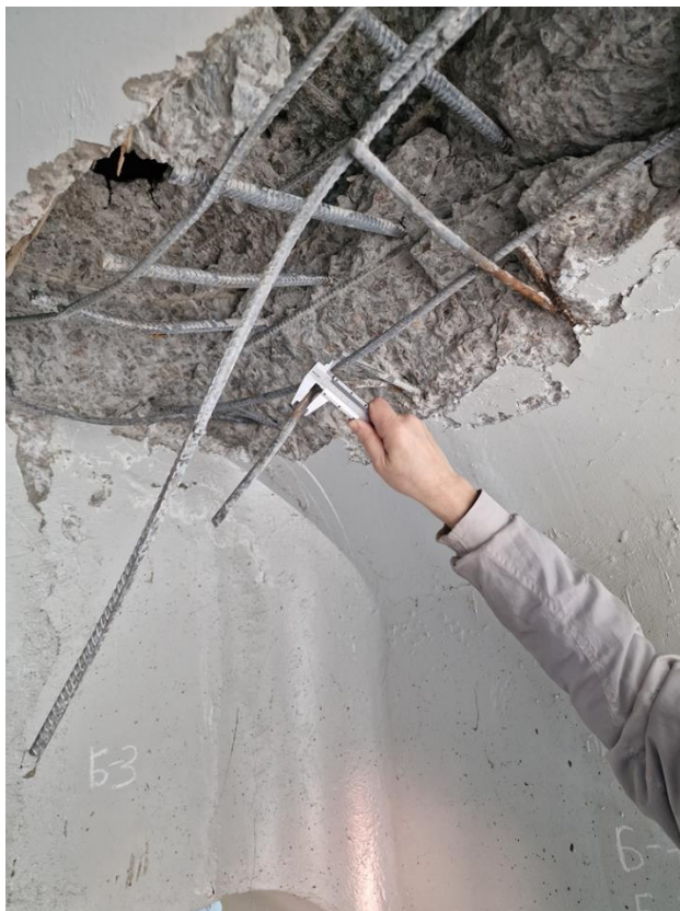
Рис. 4. Вихідний отвір з вивалом бетону в плитній частині залізобетонних балок прогонових будов
