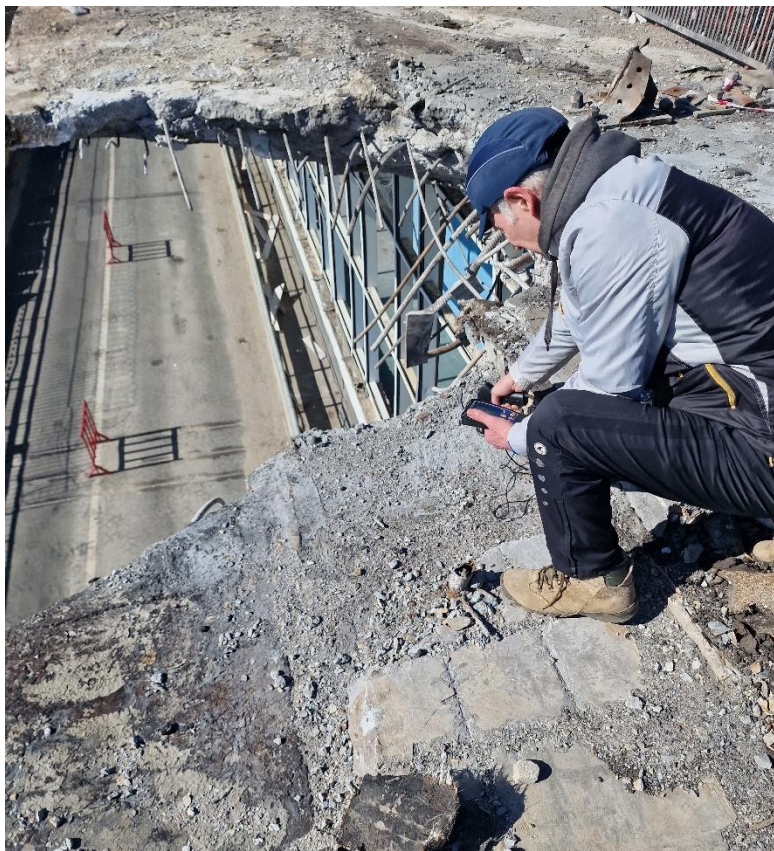
Рис.1. Наслідки ракетного удару, руйнування плити покриття, контроль міцності бетону
